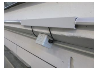
Bild zeigt Kabelweg mit Klemmverteiler
